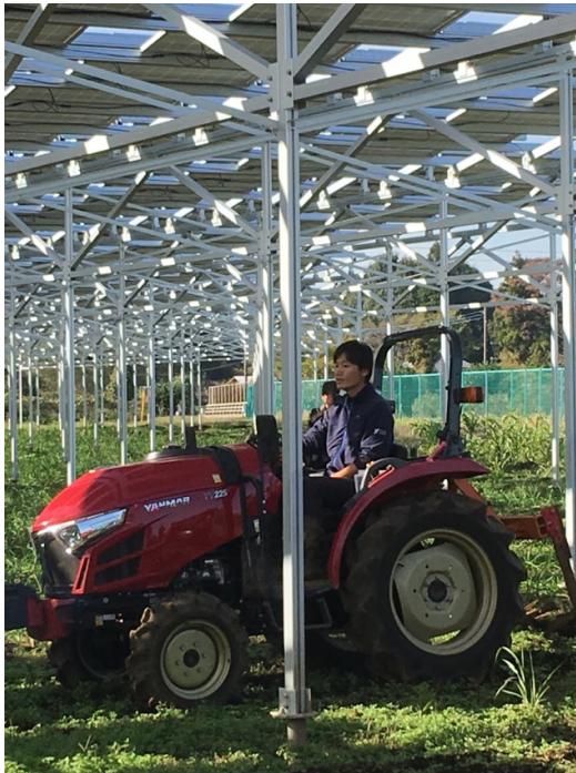
千葉エコ・エネルギー 千葉市大木戸アグリ・エナジー1号機
