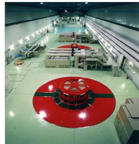
可変速揚水発電設備の外観
