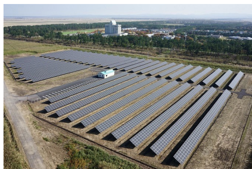
大潟共生自然エネルギー発電所
