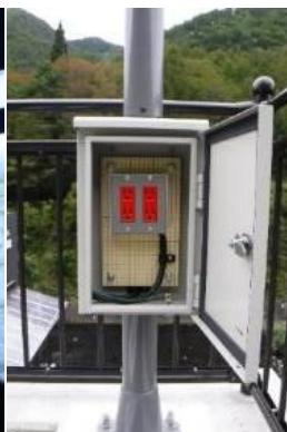
非常用コンセント
